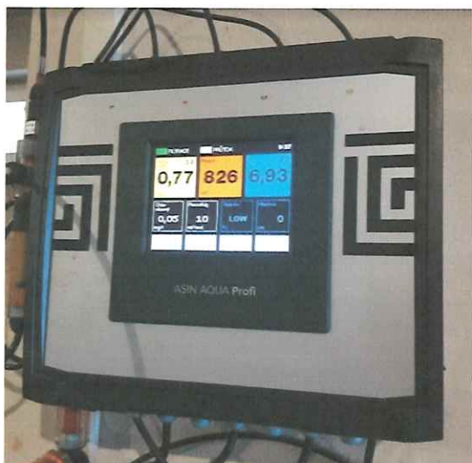
Obr. č. 9 Řídicí jednotka úpravny vody
